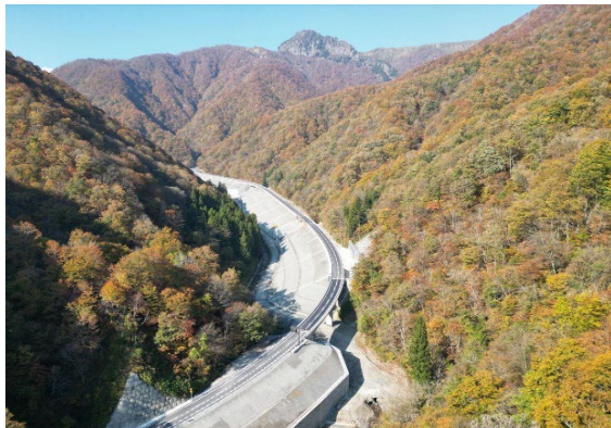
冠山峠道路塚地区改良舗装工事 (国土交通省近畿地方整備局)
