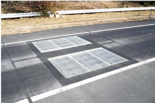
写真-3 20万輪通過後の状況
