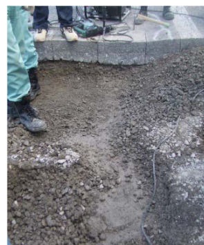
写真-1 深層部が滞水・泥土化し水が浸透している事例
