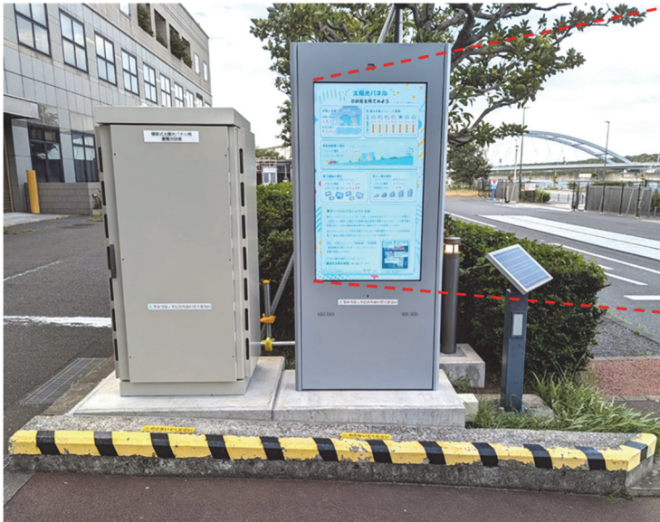
デジタルサイネージ設置状況
