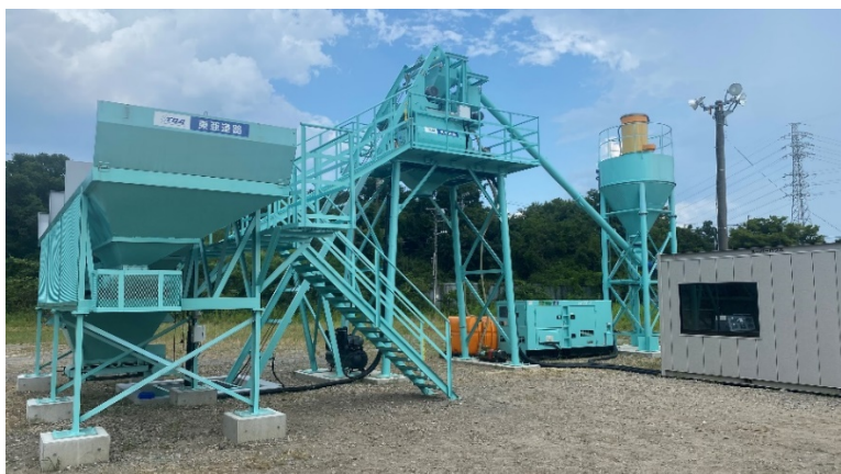
写真-1 常温アスファルト混合物プラントの全景
