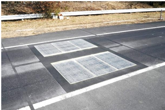
写真-3 20万輪通過後の状況
